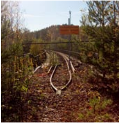
All fredsel over viadukten er i dag forbudt. Foto: Roger Phil
